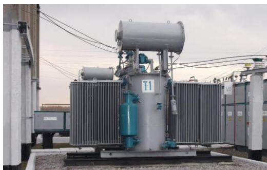
Рисунок 2 - Непрерывная сушка трансформаторного масла и твердой изоляции с помощью адсорберов на подстанции
