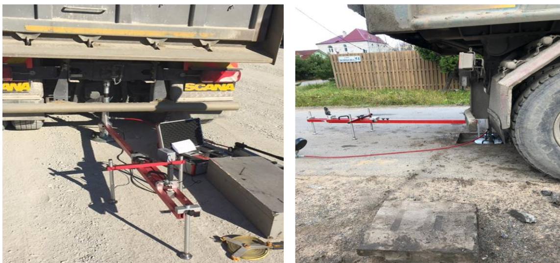
Рисунок 2 – Установка статического штампа на поверхность грунта земляного полотна и слоёв основания дорожной одежды
