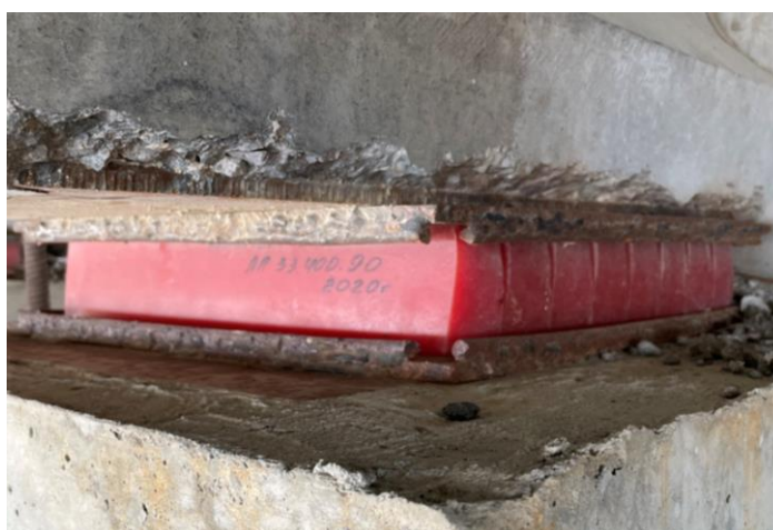
Рисунок 4 – Полиуретановая линейно-подвижная опорная часть типа ЛП 33.400.90 на крайней опоре №1
