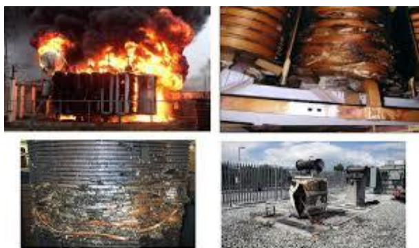
Рисунок 1 – Повреждения в силовых трансформаторах
